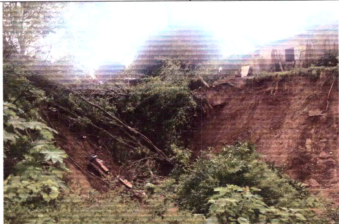
FOTO 02 - Vista do deslizamento e das arvores derrubadas com as fortes chuvas
