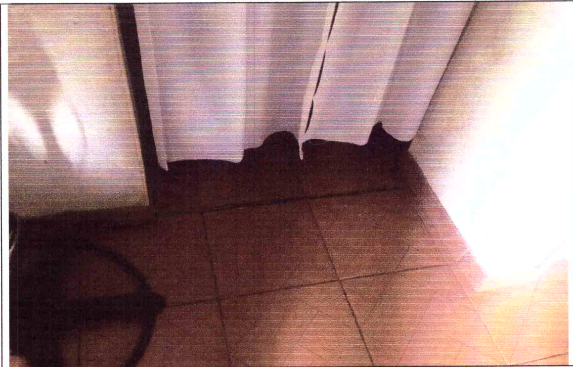
FOTO 07 – Vista do trinco no piso devido ao recalque de fundação na residência
