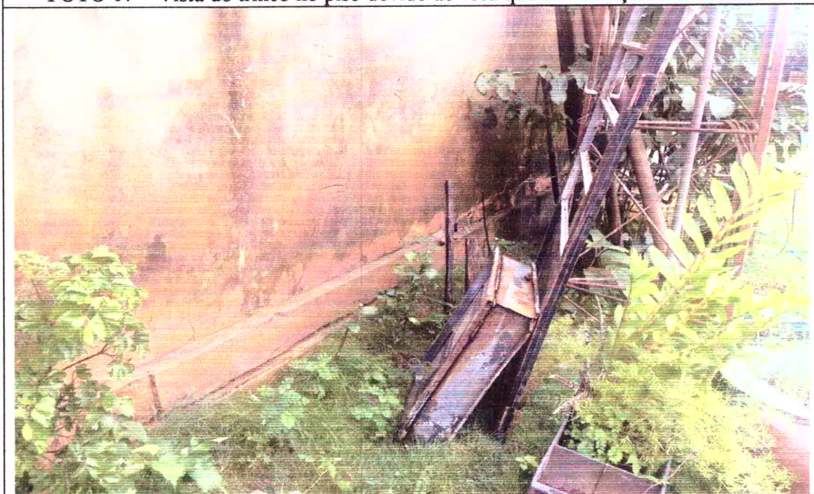
FOTO 08 - Vista Do desligamento da alvenaria e fundação devido ao recalque na residencia
