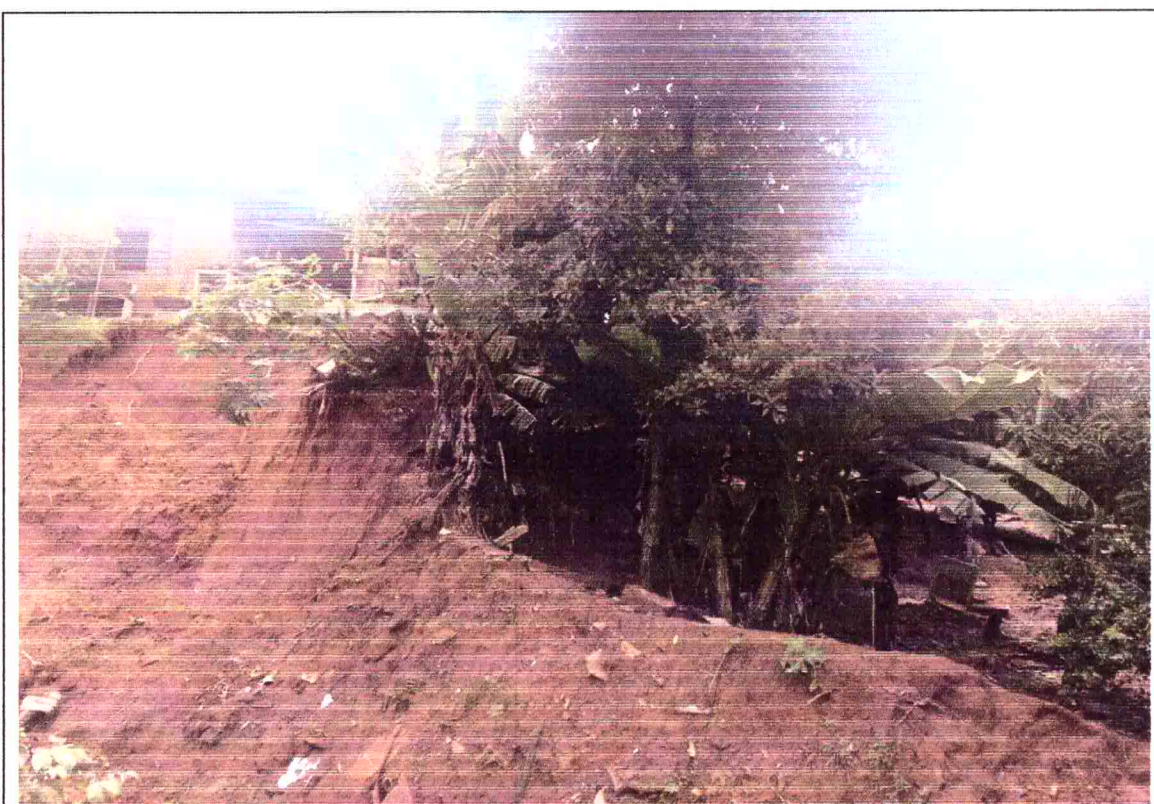
FOTO 03 - Vista deslizamento do barranco próximo a residência
